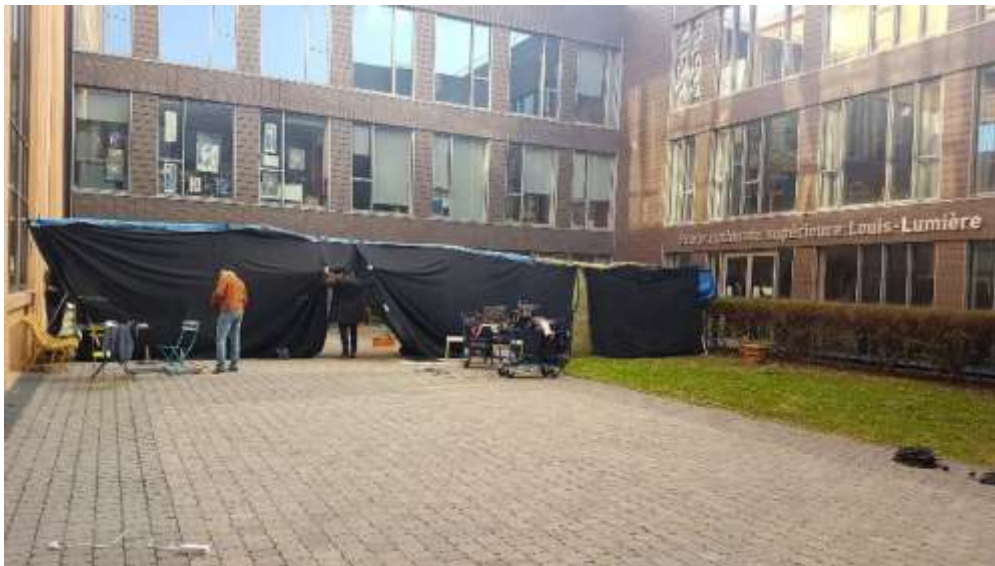
Figure 134 - Mise en place de la séparation en borniols et bâches. Photo personnelle.
