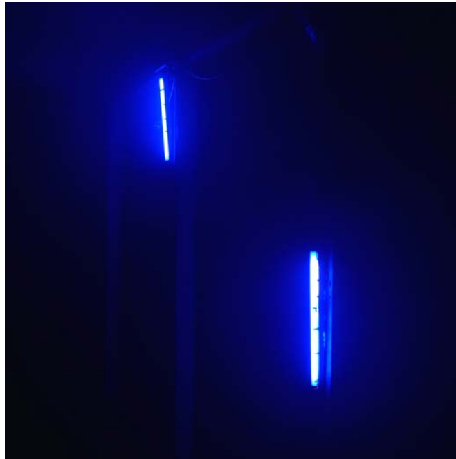
Figure 43. Tubes fluorescents à l'entrée de la pièce 4
