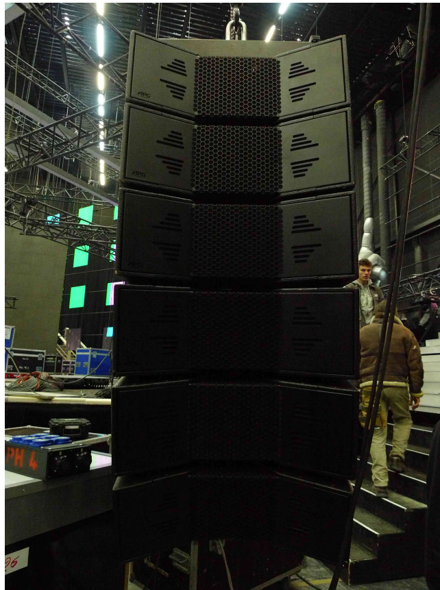
FIGURE 16 – Montage du système principal installé sur le plateau de l'émission The Voice
